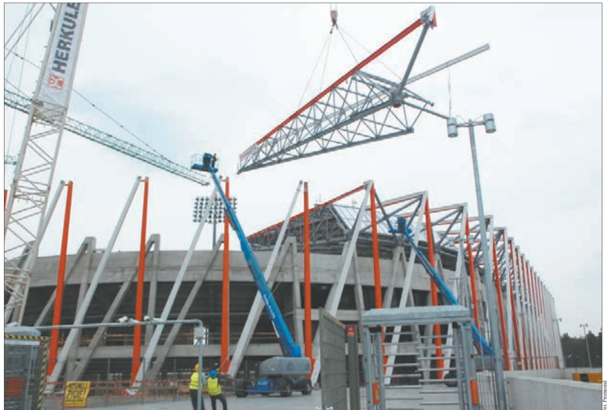
W tym tygodniu nad stadionem przy Słonecznej zostanie zamontowanych pięć tzw. serków, które stanowią część konstrukcji dachu
